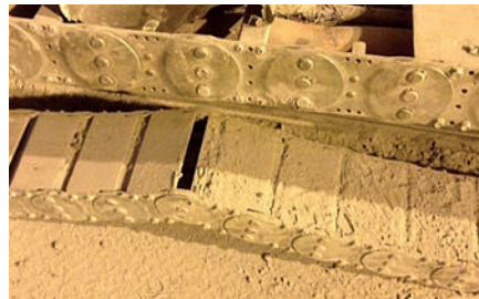
Negativbeispiel: Deckelsystem bei hohem Staubaufkommen
